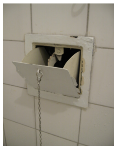
Klaffventil med kedja, reglerbar i tre lägen. Ska kunna fungera efter att man gjort en OVK och åtgärder.
