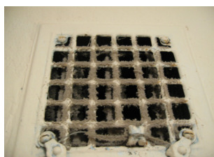
Ett galler med bakomliggande spjäll som regleras med trissor och kedja. Efter en OVK ska dessa don med spjäll fungera som de var tänkta när de installerades få 100 år sedan.
